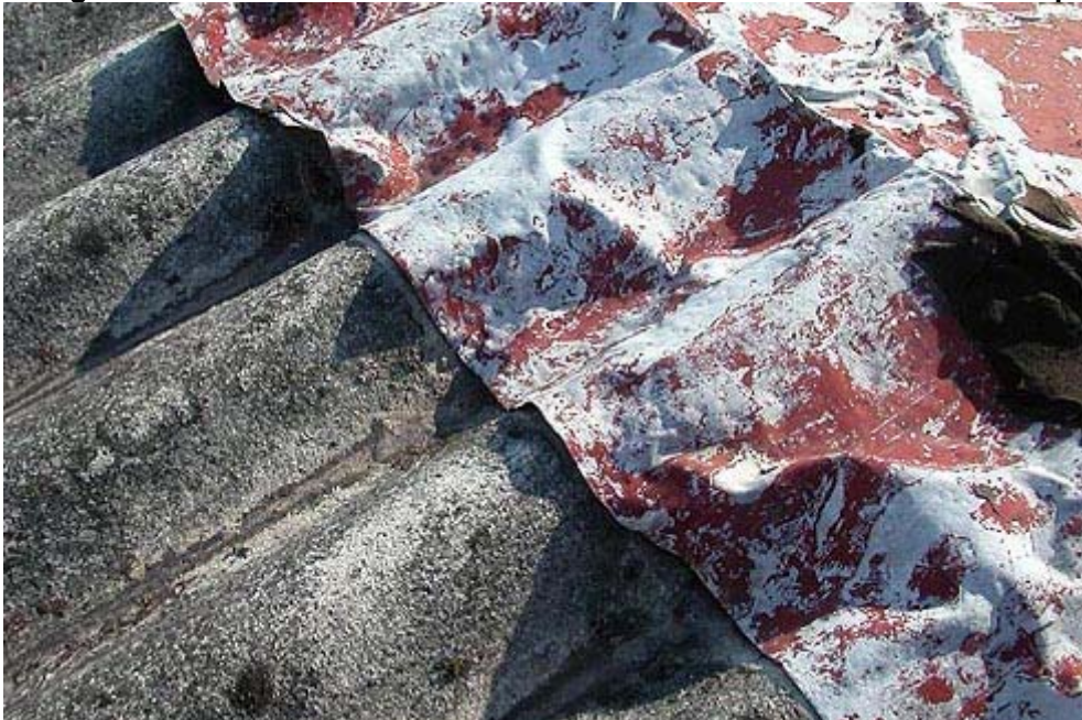
Abbildung 15: Abschlussblech aus Blei auf einem Dach aus Asbestzement-Wellplatten
