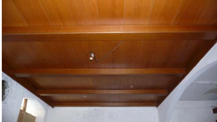
Abbildung 42: Mit Holzschutzmittel behandelte Holzdecke
