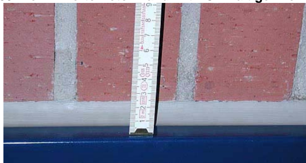
Abbildung 39: Verklankerte Betonwand mit PCB-haltiger Dehnungsfuge
