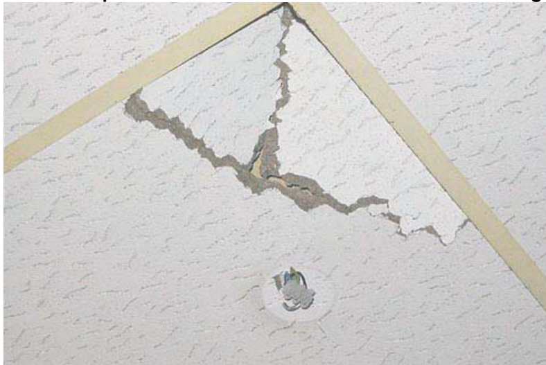
Abbildung 41: Deckenplatte aus Künstlicher Mineralfaser mit PCB-haltigem Anstrich
