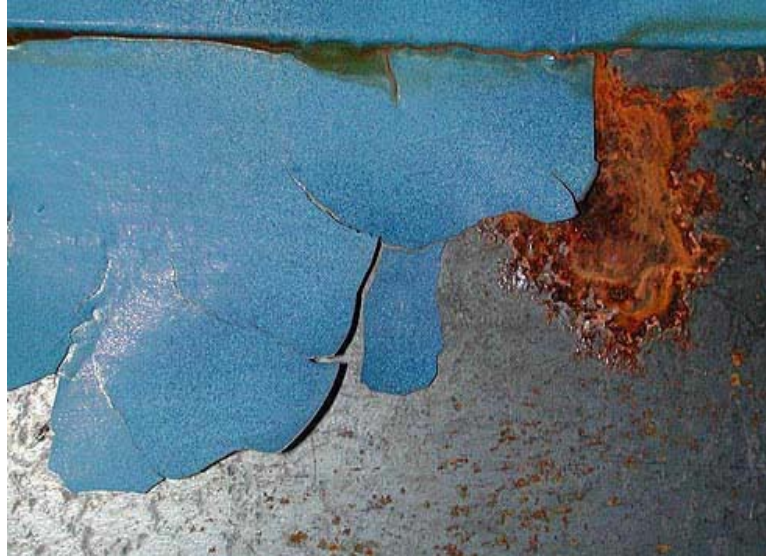
Abbildung 40: Lackfarbe mit PCB-Verdacht auf Metalloberfläche
