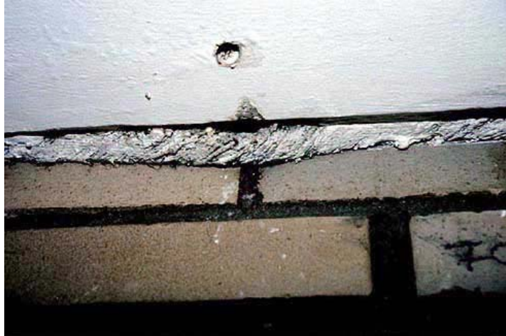
Abbildung 7: Asbestschnur zwischen Klinkerwand und Decke
